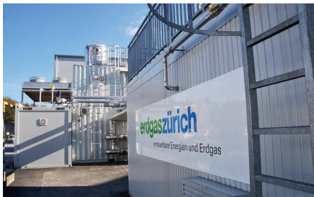
Biogasanlage in Volketswil.
