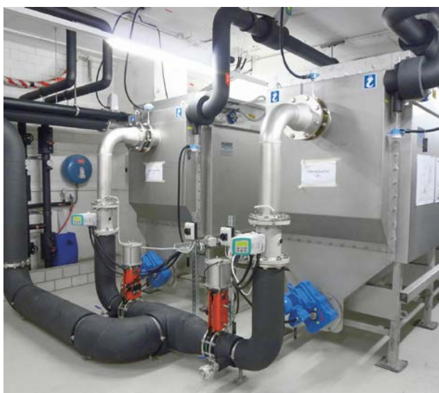
Wärmepumpen sind das Herzstück der Abwasserwärmenutzung; Wärmetauscher wie hier auf dem Foto rechts liefern die Wärme aus dem Abwasser (Foto: InfraWatt)
