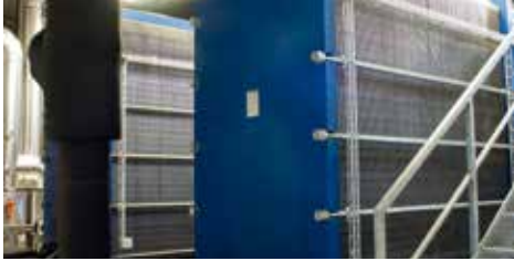
Échangeur de chaleur à plaques
