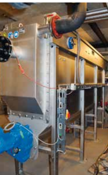
Échangeur dans la cave du bâtiment
