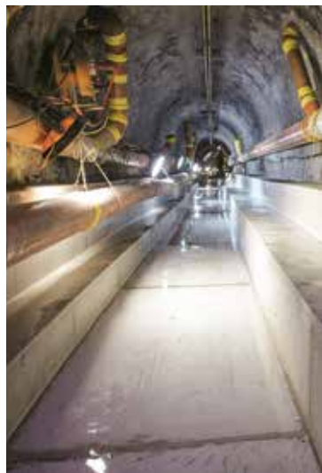
Canalisation d'eaux usées avec échangeur
