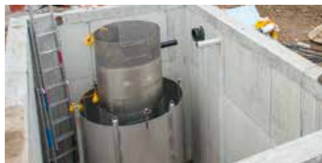
Échangeur de chaleur dans un puits
