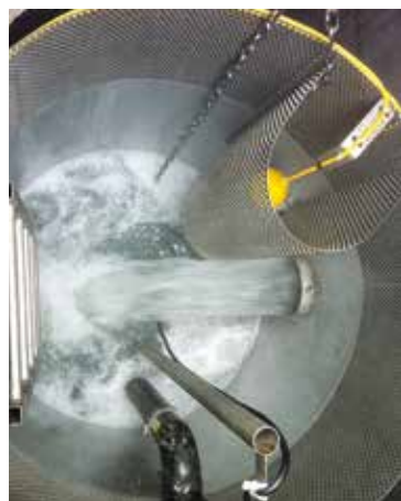
Puits avec échangeur de chaleur
