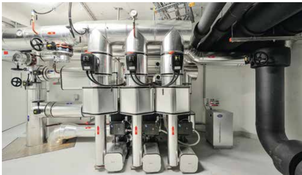
Centrale de chauffage du réseau de chaleur Kasino, à Aarau
