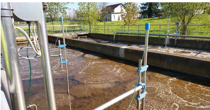
Gerade in der Biologie (im Bild mit Messtechnik) liessen sich auf der ARA Obfelden einige Energieeinsparungen umsetzen.
