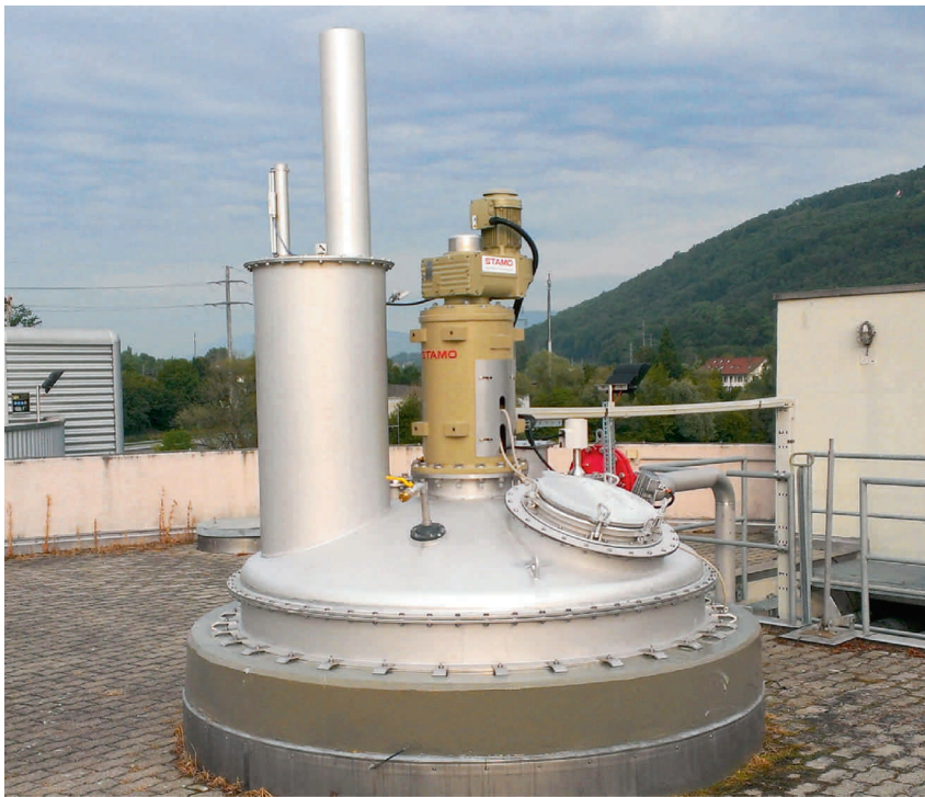
Fig. 2 Der Schlammstapel wurde mit einer gasdichten Haube versehen. So kann das dort entweichende Gas gefasst und energetisch genutzt werden
