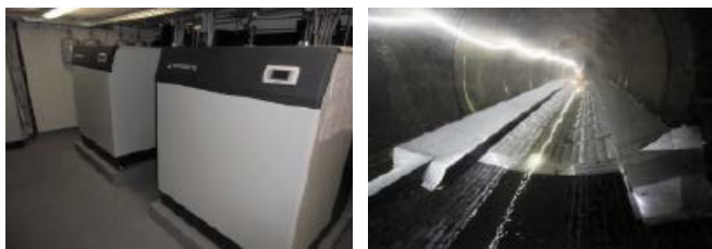
Abb. 1: Abwasserwärmepumpen (l.) und Abwasserwärmetauscher im Kanal (r.)
